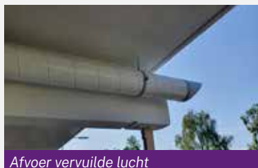
Afvoer vervuilde lucht
